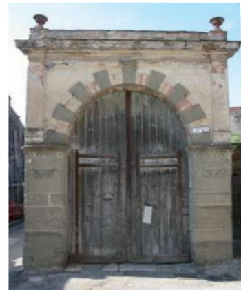
portale con arco a tutto sesto in mattoni laterizi alternati a conci di pietra squadrata su stipiti lapidei
