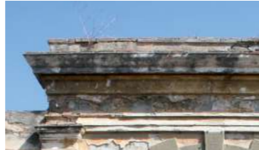
cornice di coronamento di portale modanata realizzata in mattoni laterizi intonacati con muretto d'attico che nasconde la copertura
