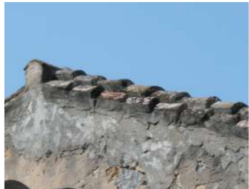
coronamento con doppia fila di tegole convesse, disposte a filo muro o livemente sporgenti
