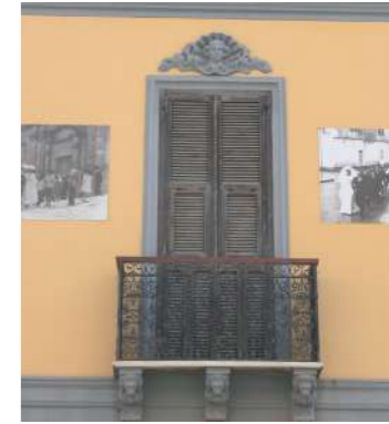
portafinestra di balcone di palazzetto con piattabanda lapidea e cornice intonacata in rilievo; il serramento vetrato è protetto da persiane
