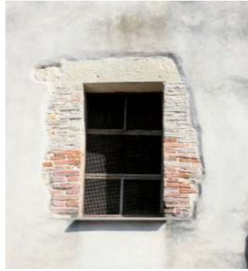
finestra con stipiti in mattoni laterizi a due teste e architrave lapideo squadrato
