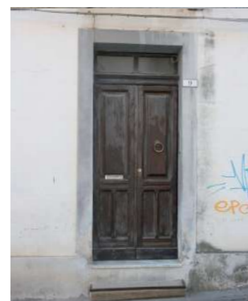
porta a due ante di palazzetto con sopralluce vetrato e cornice in rilievo in intonaco
