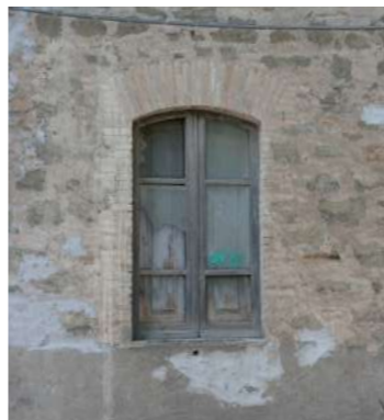
finestra con arco ribassato in mattoni laterizi a tre teste e stipiti rifiniti in laterizio e serramento a due ante vetrate protette da scurini interni
