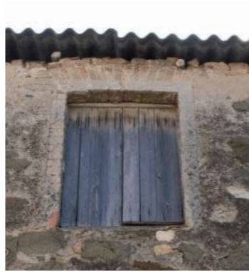
finestra con stipiti e piattabanda in mattoni laterizi e serramento arcaico a due ante cieche realizzate in tavole disposte verticalmente
