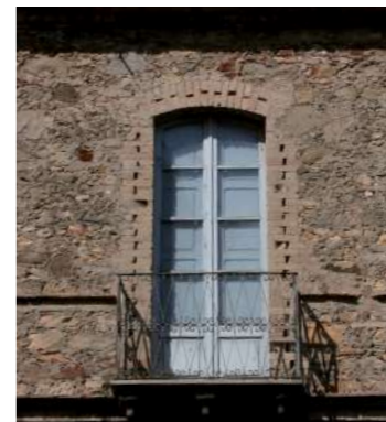
portafinestra di balcone di palazzetto con stipiti e arco ribassato in mattoni laterizi a due teste con serramento a due ante vetrate protette da scurini
