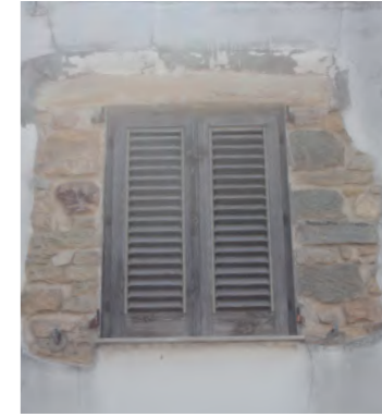
finestra con architrave lapideo e serramento a due ante vetrate protette da persiana esterna lignea a lamelle
