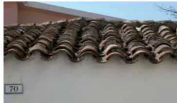
aggetto semplice della prima fila di coppi con smaltimento diretto delle acque
