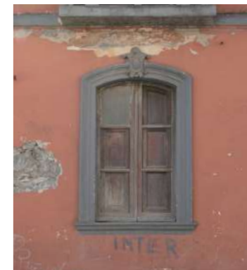
finestra di palazzetto con arco ribassato in conci lapidei e cornice di intonaco che contorna la bucatra, con serramento a due ante vetrate
