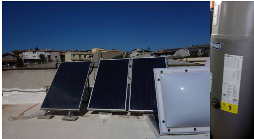
Figura 17. Impianto solare termico con scaldacqua a pompa di calore installato presso la scuola dell'infanzia
