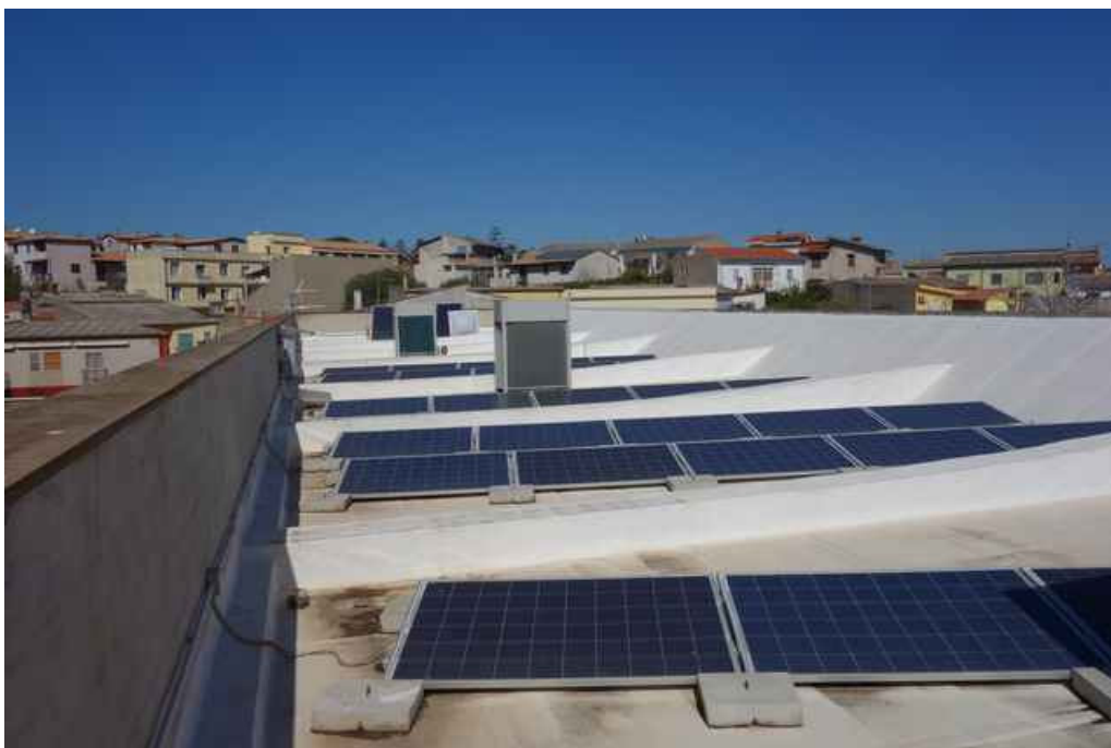
Figura 18. Campo fotovoltaico da 10 kW installato sul blocco dei servizi
