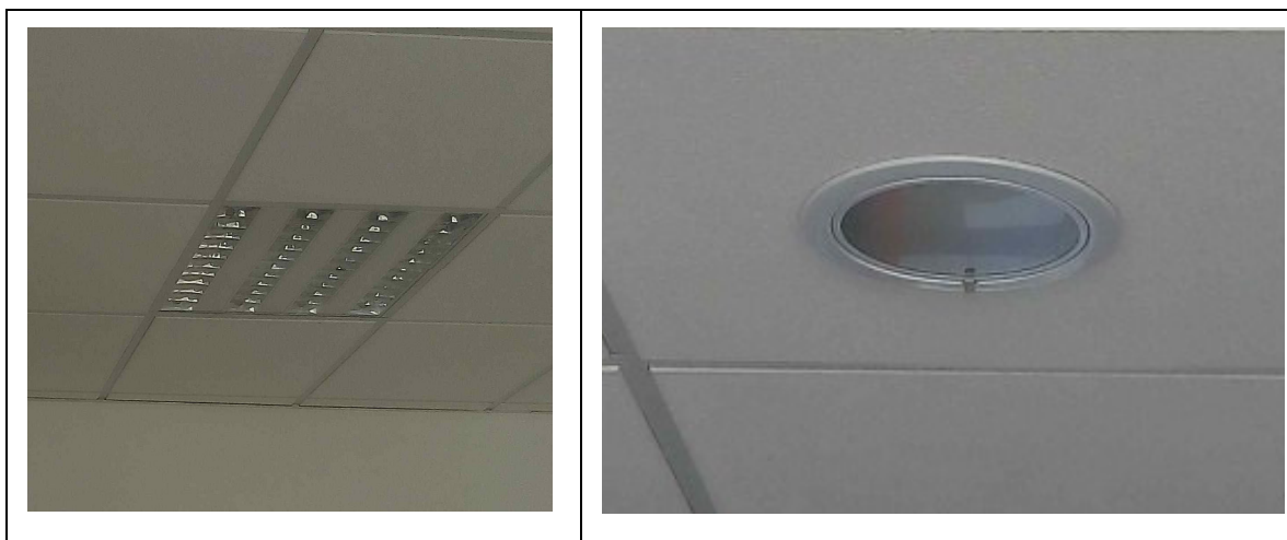
Figura 19. Alcune lampade e apparecchi installati nelle aree interne della struttura
